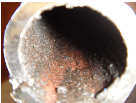
(a) Estado de corrosión de las tuberías
