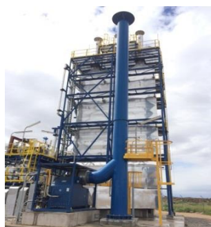
Figura 2. Demostrador de la tecnología HYSOL en Manchasol
