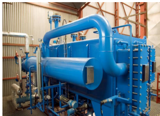
Figura 1: Bomba de calor de doble efecto en el sistema AQUASOL
