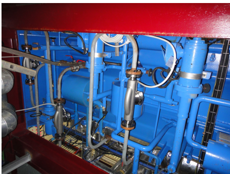
(e) Vista general de los caudalímetros
