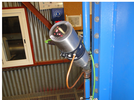
(f) Válvula automática
